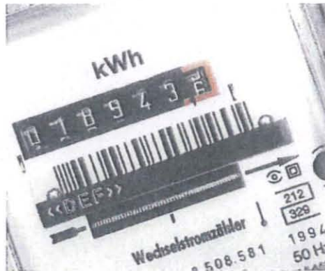
Strom: mindestens 2 x pro Jahr kontrollieren, ggf. Unterzähler einbauen.
